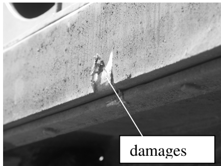
Fig. 2. Damages of the approach bank strip and flap Rys. 2. Uszkodzenia listwy pomostu i kłapy obrotowej (flapa)
